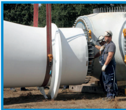
psm verhindert Totalschaden: Ein Beispiel mit gutem Ausgang:
